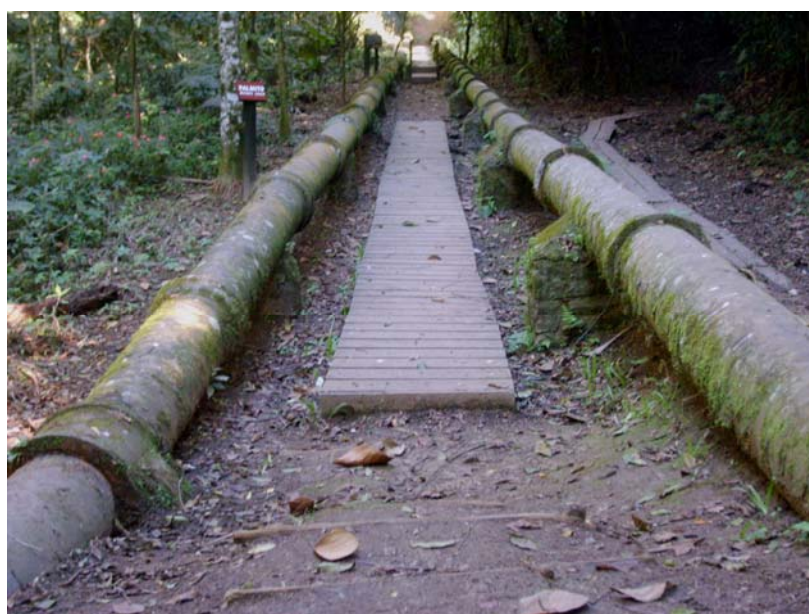
Figura 30 – Vista dos dutos ao longo da trilha
